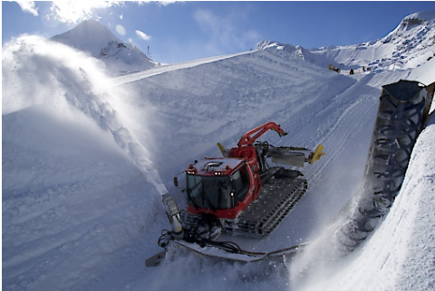
Das Pipemonster beim Bau der 160 langen und 6,6 m hohen Superpipe am Kitzsteinhorn
